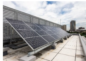
太陽光発電設備
