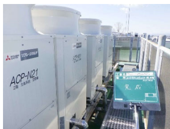
高効率空調機
