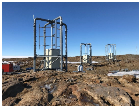
昭和基地の風力発電設備（縦軸型）
