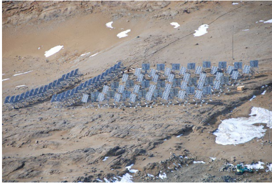
昭和基地の太陽光発電設備
