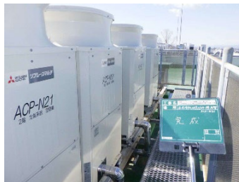
高効率空調機
